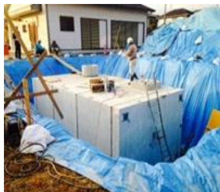
真野北支所に設置された耐震性貯水槽
