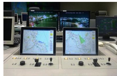
高所監視カメラ操作卓
