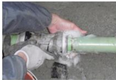
【SGM継手部分からのガス漏えい状況】
