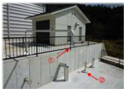
【緊急給水口（藤尾奥町配水池）】 ①給水車補給用の緊急給水口 ②地上式消火栓型の緊急給水口】
