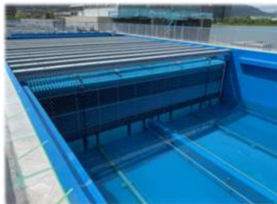
【柳が崎浄水場 沈澱池傾斜板沈降装置】
