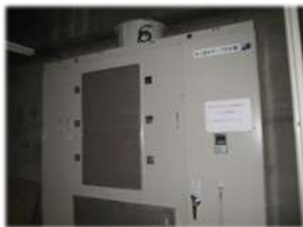
【インバーター※19送水設備（真野浄水場）】
