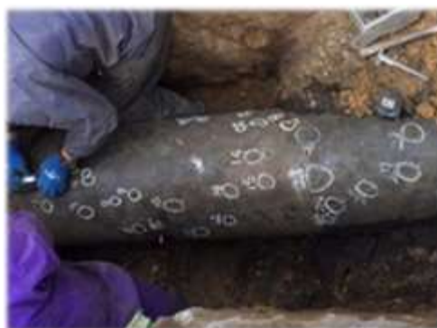
【老朽化し、管外面が腐食している水道管】
