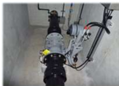
【緊急遮断弁（藤尾奥町配水池）】
