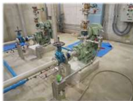
【新瀬田浄水場 下水道放流設備】
