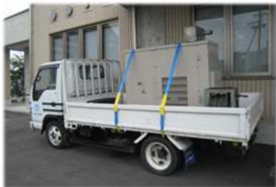
【可搬式自家発電設備】
