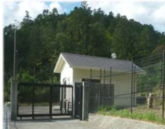
【南小松加压施設】
