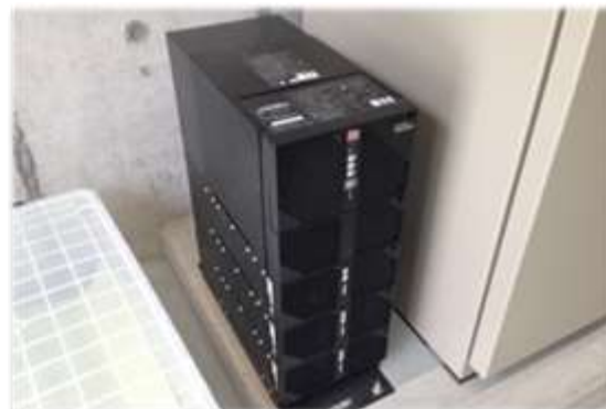
【無停電電源装置（UPS）】
