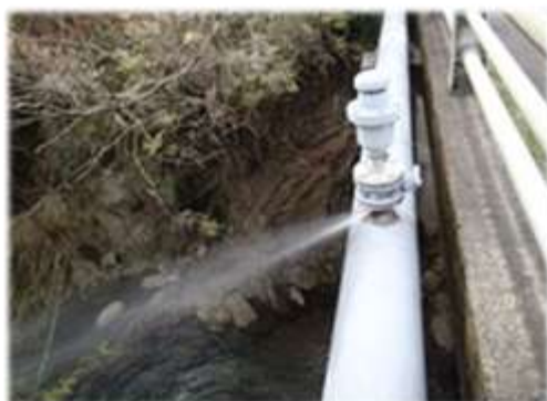
【水管橋の漏水状況】
