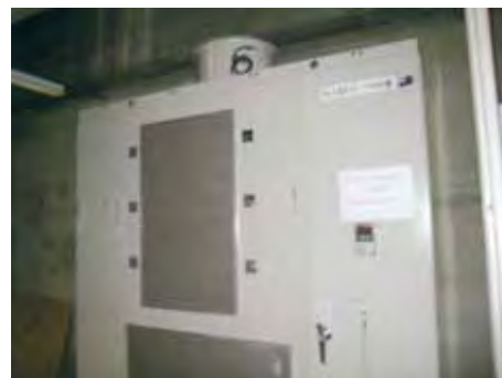
インバーター※12送水設備（真野浄水場）
