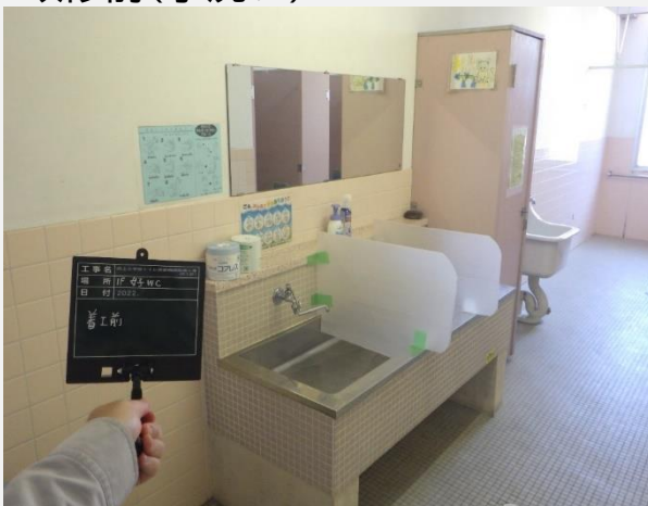
▶改修前(手洗い)
