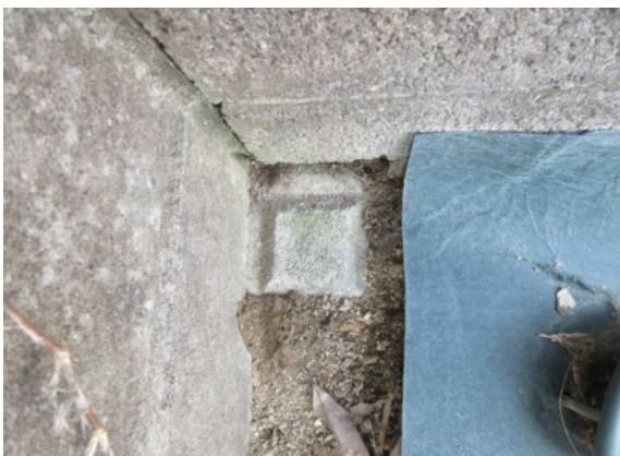
D 2 5 - 1 1 5 (近景) コンクリート杭
