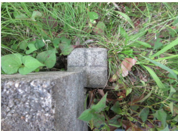
D 2 5 - 1 1 3 (近景) コンクリート杭
