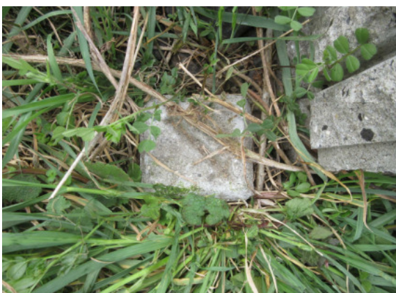
D12-119 (近景) コンクリート杭
