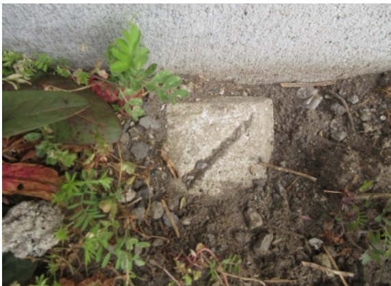
D12-54 (近景) コンクリート杭
