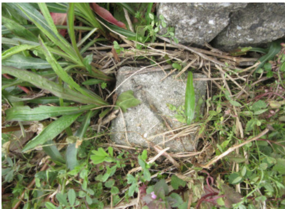
D12-118 (近景) コンクリート杭
