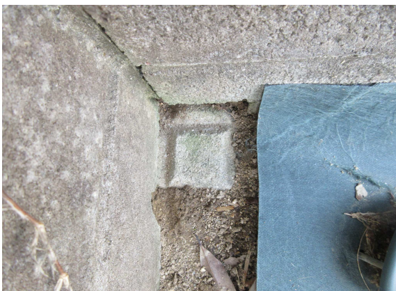
D 2 5 - 1 1 5 (近景) コンクリート杭
