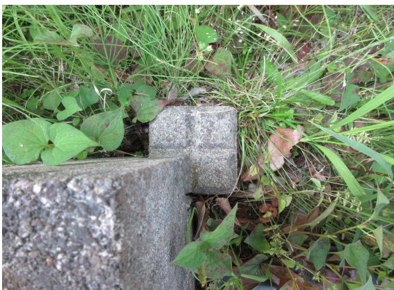
D 2 5 - 1 1 3 (近景) コンクリート杭
