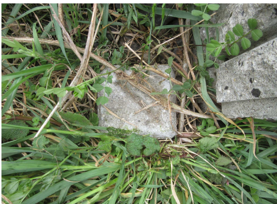
D12-119 (近景) コンクリート杭
