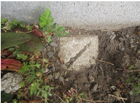
D12-54 (近景) コンクリート杭
