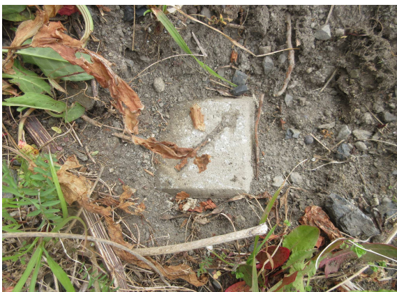
D12-53 (近景) コンクリート杭
