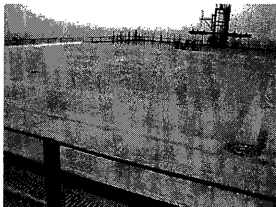
屋上のヘリポート。救援物資を空路で受け入れることも可能。
