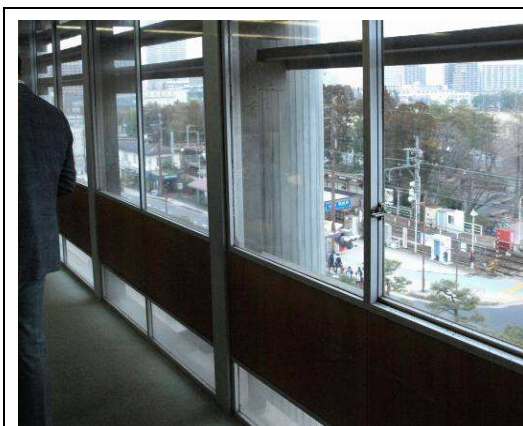
アルミサッシの劣化および FIX 窓のクリアランス不足
