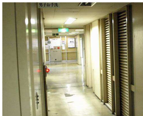
床等、内装仕上げ材の劣化
