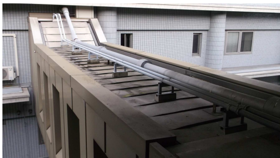
本館～新館の渡り廊下上部の給水配管。免震フレキシブル対応が必要
