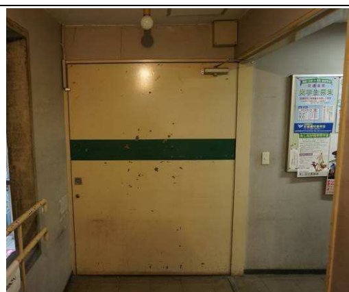
防火扉堅穴区画部の遮煙性能未対応
