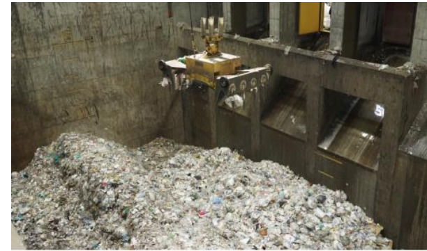
ごみピット、ごみクレーン
