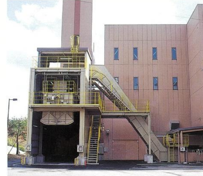
●飛灰バンカ Fly ash bunker
