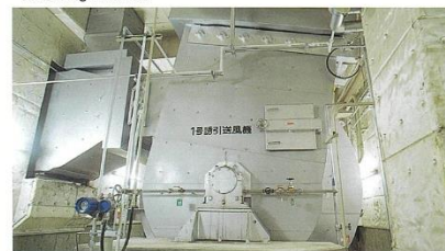
●誘引送風機 Induced-draft fan
