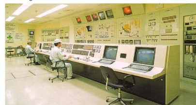
●中央制御室 Central control room
