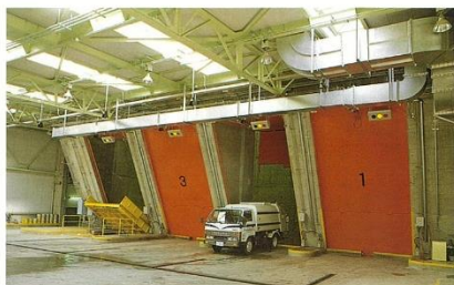
●プラットフォーム、ごみ投入扉、ダンピングボックス Platform, dumping door and dumping box
