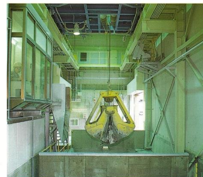
●灰ピット、灰クレーン Main ash pit and ash crane
