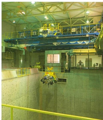
●ごみピット、ごみクレーン、投入ホッパー Refuse pit, refuse crane and refuse hopper
