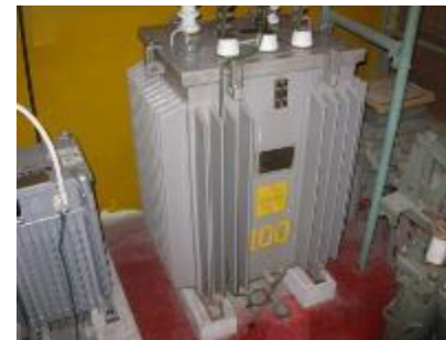
《PCB 含有の可能性のある電気機器》 （変圧器）
