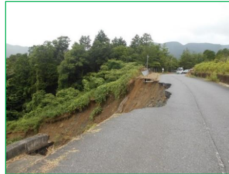
被災状況(令和2年7月発生)
