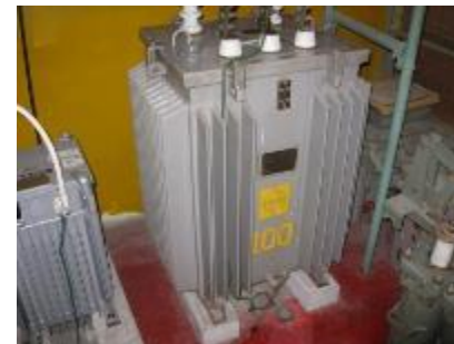
《PCB含有の可能性のある電気機器》 （変圧器）
