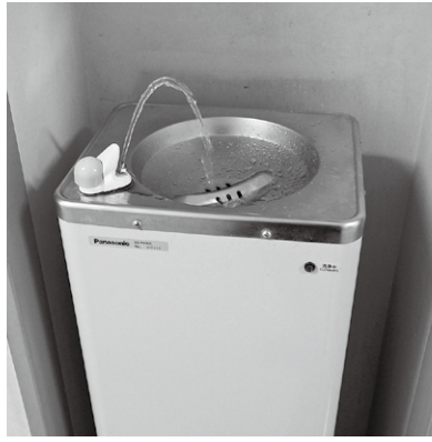
公共施設内に設置されている冷水機
