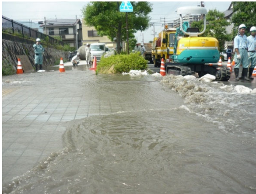
大津市御陵町水道管漏水事故状況
