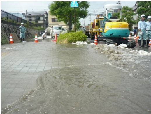
大津市御陵町水道管漏水事故状況
