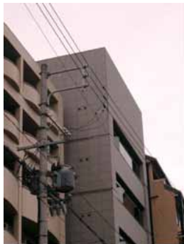
屋上の壁面（パラペット）を高く立ち上げることにより、屋上の設備を目隠しした例
