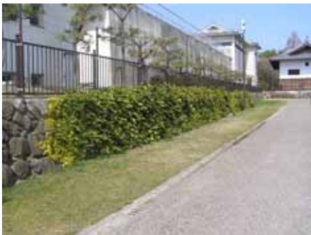
擁壁の前面を緑化することで、周辺の景観に調和させてた例
