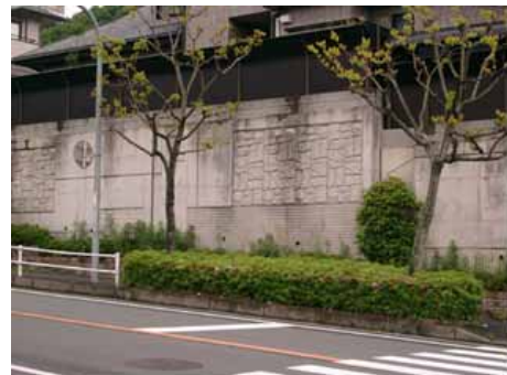
コンクリートの擁壁を化粧型枠により修景処理することでまちなみ景観に変化を与えている例
