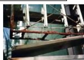
袖看板の底部脱落
