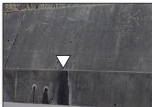
地下水の流出
