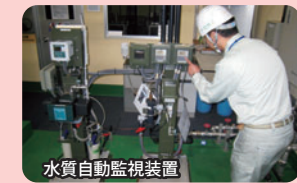
水質自動監視装置
