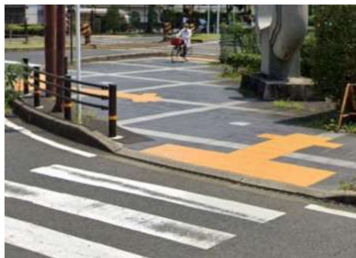
交差点部における点字シートの設置
