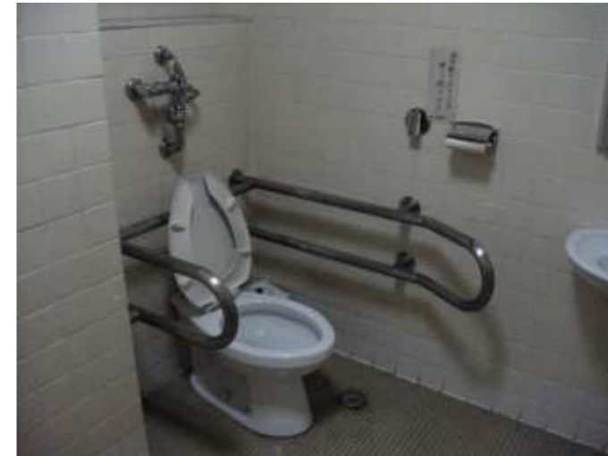
オスメイト設置スペースがないため個別での改修が困難 経済性等を考慮し大規模改修等に整備
