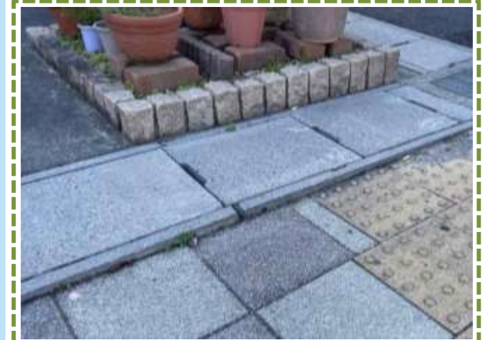
④歩道舗装(インターロッキング)の段差
