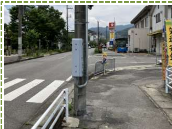
①歩道舗装(アスファルト)の状態が悪い
