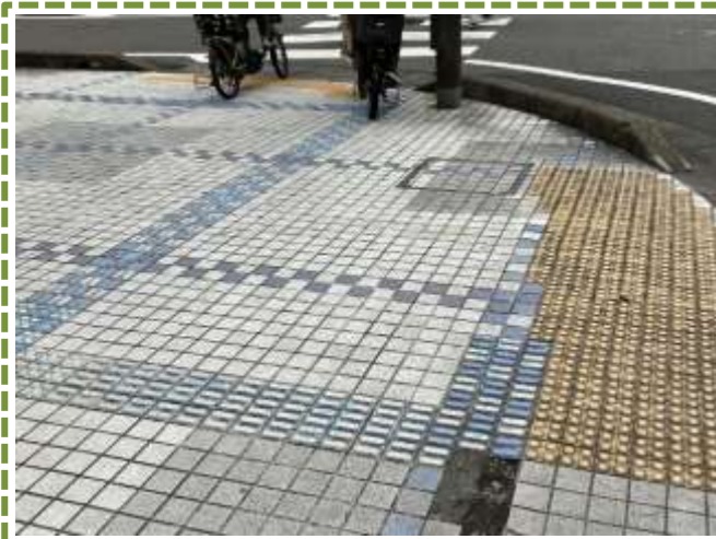
①視覚障害者誘導用ブロックの視認性が悪く、配置も違う
