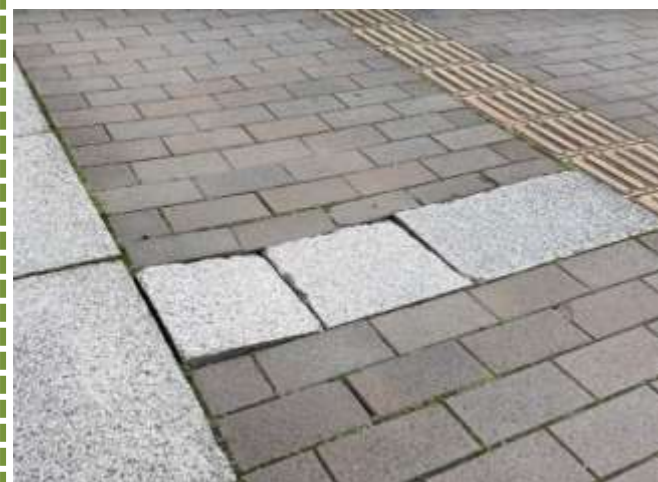
③歩道舗装(石板)のがたつき
