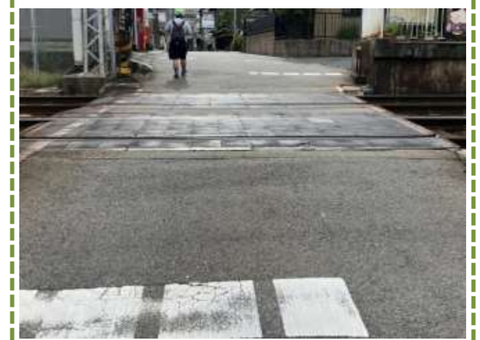
⑥外側線がない
