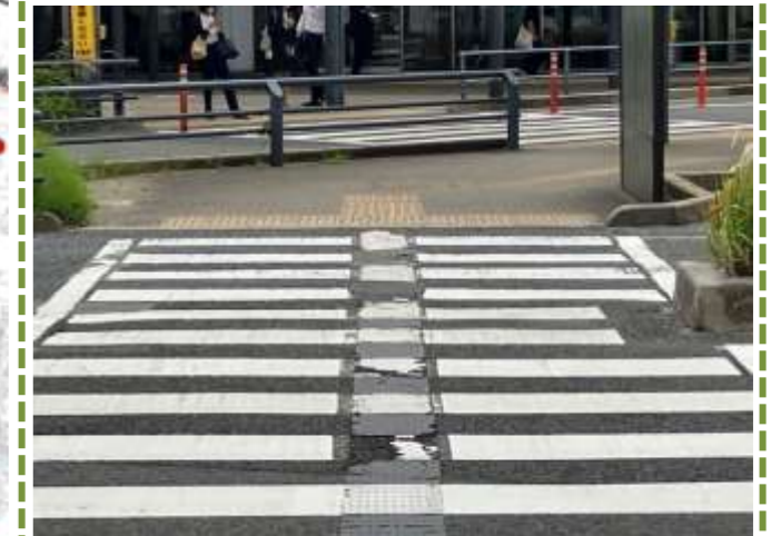
⑥エスコートゾーンの破損
