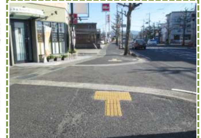
④視覚障害者誘導用ブロックの連続性がない
