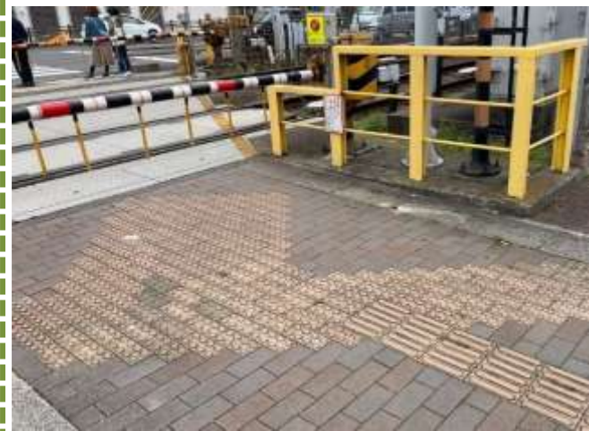
②視覚障害者誘導用ブロックの配置が違う
