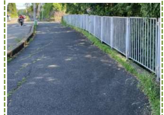
⑥歩道舗装(アスファルト)の状態が悪い
