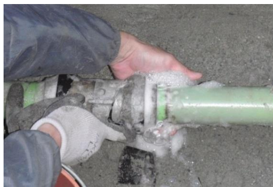
【SGM継手部分からのガス漏えい状況】
