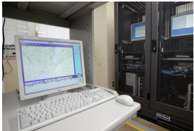
【ガバナ遠隔監視制御システム監視室】
