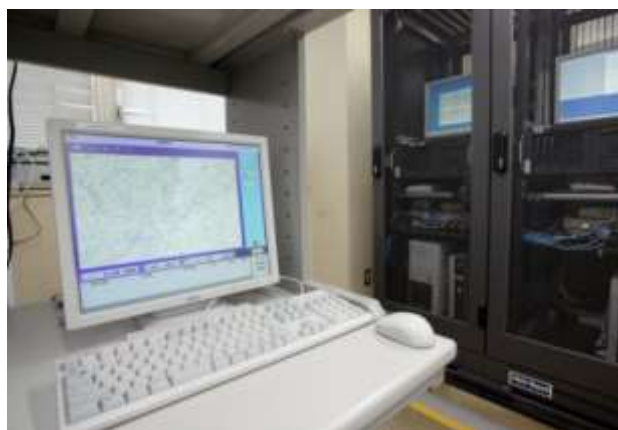
【ガバナ遠隔監視制御システム監視室】
