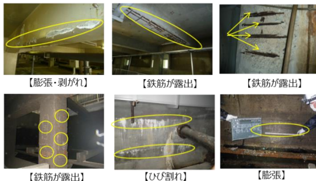
I系水処理施設 躯体の劣化状況
