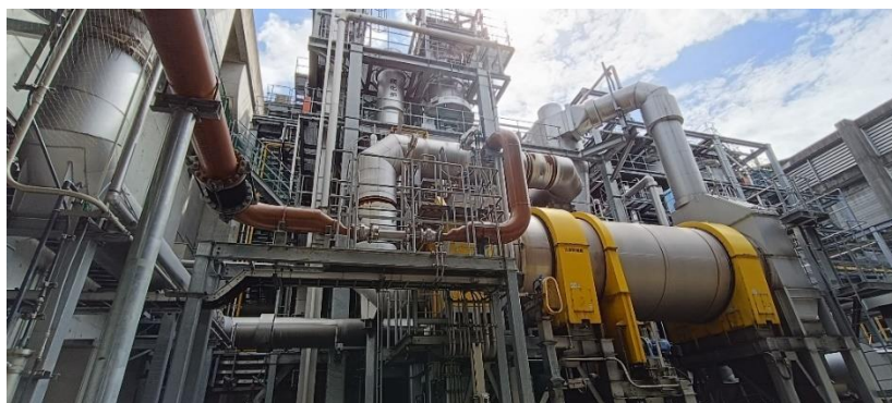
【湖西浄化センター 汚泥燃料化施設（炭化炉）】
