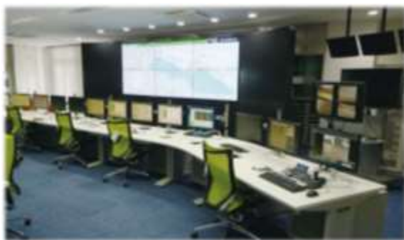
【浄水管理センター中央監視室】
