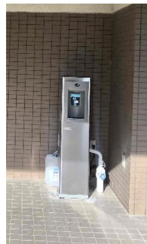
【補助金を活用し設置された冷水機】
