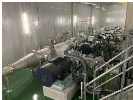
【更新した柳が崎浄水場 送水ポンプ設備】
