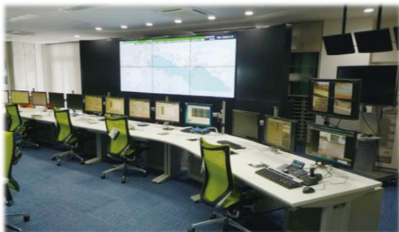
【浄水管理センター中央監視室】
