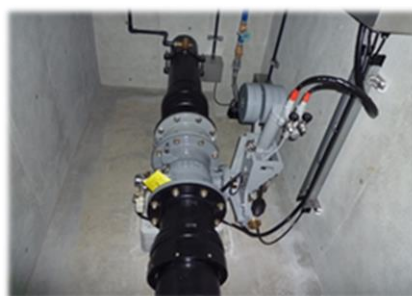
【緊急遮断弁（藤尾奥町配水池）】
