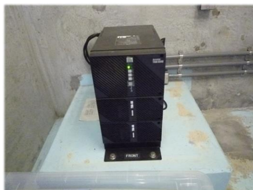
【無停電電源装置（UPS）】
