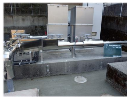
【インバーター※34 送水設備 (桐生加圧ポンプ場)】
