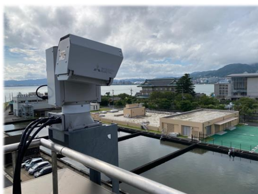
【浄水施設の監視カメラ（柳が崎浄水場）】
