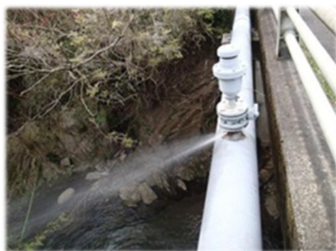
【水管橋の漏水状況】
