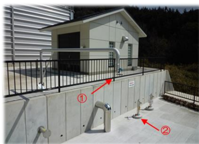
【緊急給水口（藤尾奥町配水池）
