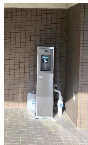
【補助金を活用し設置された冷水機】
