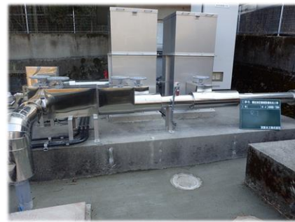
【インバーター※34 送水設備 (桐生加圧ポンプ場)】
