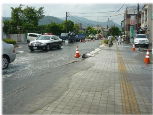
【平成26年6月御陵町水道管漏水事故の状況】
