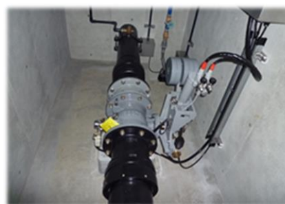
【緊急遮断弁（藤尾奥町配水池）】
