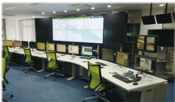
【浄水管理センター中央監視室】
