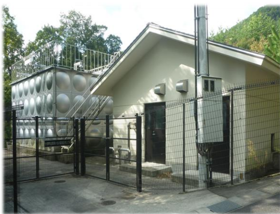
【南小松配水池及び小松の森加圧施設】
