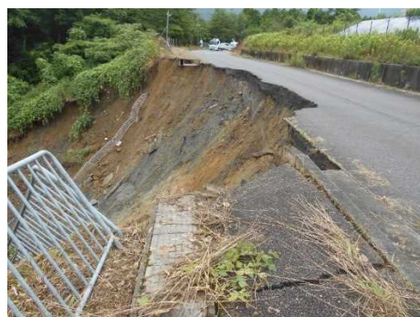
伊香立下在地町 市道幹 1001 号線（道路被災の様子）
