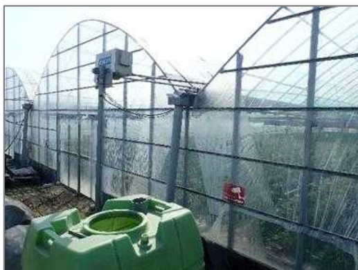
防犯カメラの設置
