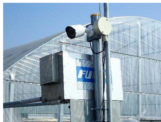
防犯カメラの設置
