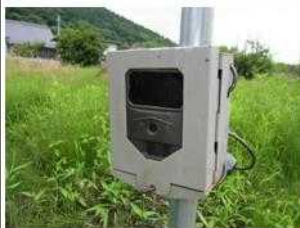
防犯カメラの設置
