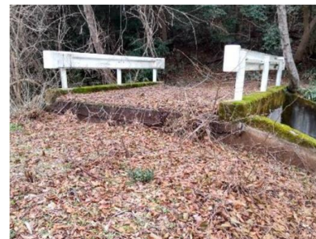
洪水吐上部工に段差 ※洪水吐が破損していないか確認 堤体沈下(崩壊)も懸念
