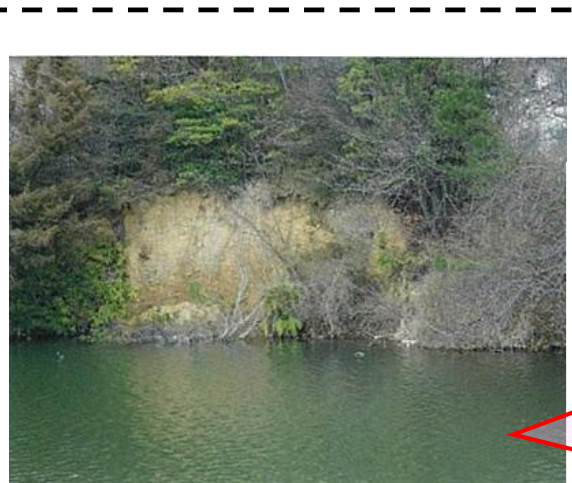
崩壊箇所の全域が分かるよう遠目で撮影
