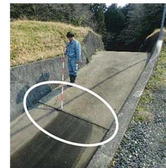
放水路部に漏水
