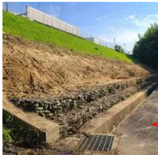
崩壊箇所の全域が分かるよう遠目で撮影
