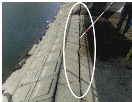
流入部にひび割れ
