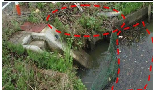
写真 38：取水部周辺の土砂やゴミの堆積
