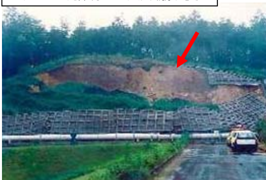
写真 41：堤体付近の法面（崩壊後）
