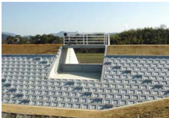
写真1：洪水吐 (香川県HPより)
