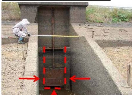
写真 37：ゲート周りの漏水
