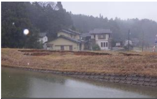
堤体の上流法面が崩落
