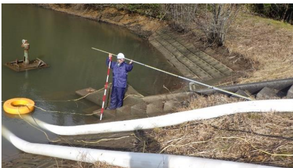
被災箇所をブルーシートで保護 災害応急用ポンプにより水位を低下
