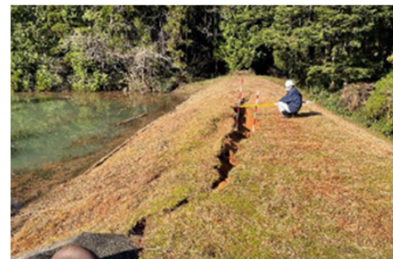
堤体の上流法面が崩落
