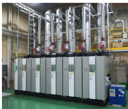
貫流ボイラー
