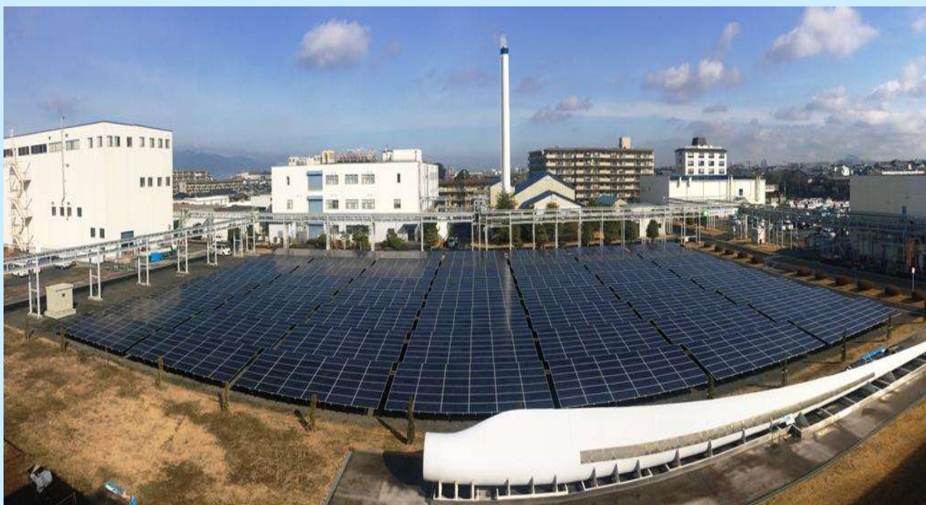
太陽光発電設備全景
